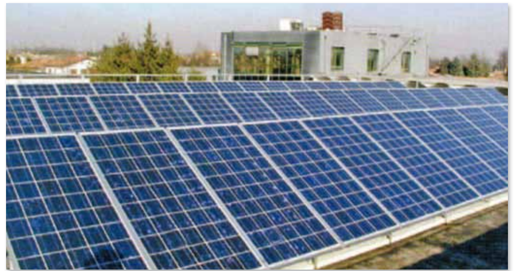
Depuracque Salzano pannelli fotovoltaici
